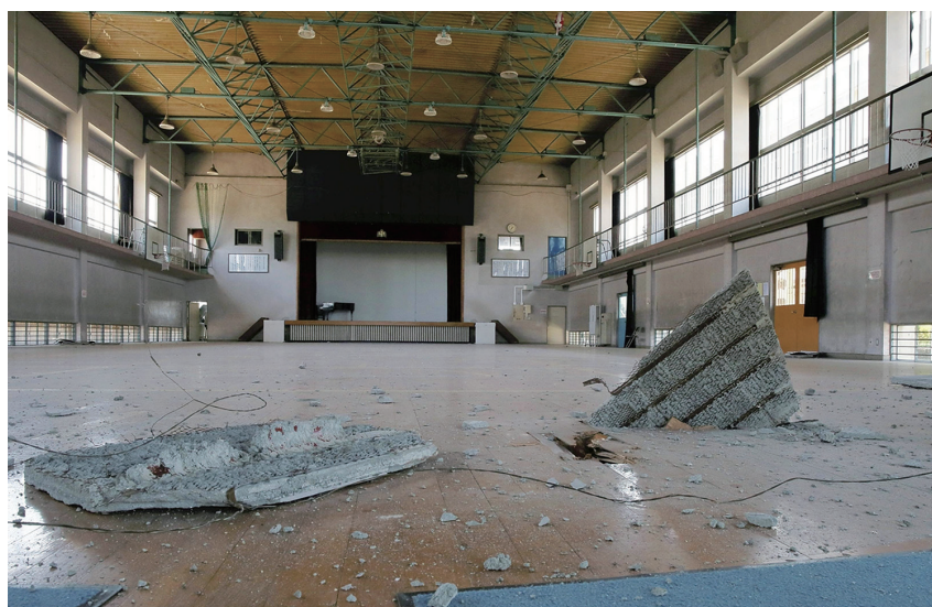
写真1: 内壁が崩れて床に突き刺さったままで使用禁止となった体育館(提供: 読売新聞社)
