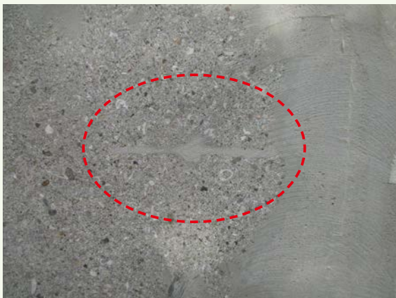
サンディングによりネットモルタル層を除去し、ピンニング位置の確認
