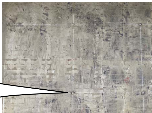
タケモルピンネット工法施工経年後、再改修時に既存塗材を剥離剤にて全面除去し、高圧水洗浄後ガードピンFタイプを増し打ちした状況
